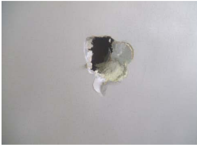
Figura 1. Placa de Yeso Dañada
